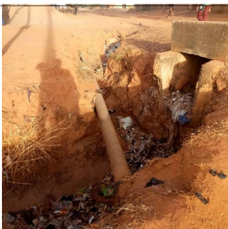
Photo 1 : Dégradation des ouvrages urbains par l'érosion pluviale à Katabirifa
