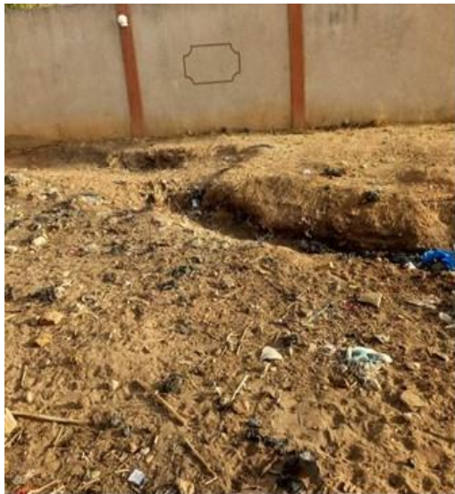
Photo 3. Clôture de maison menacée par l'érosion pluviale
