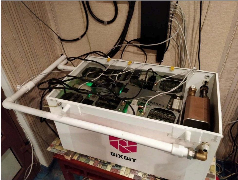
Illustration 5 - Installation de processeurs de minage reliés au système de chauffage central d'un immeuble d'Irkoutsk, le 6 avril 2019
