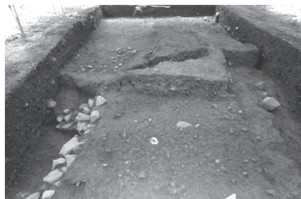
12. La Côme Chaudron. La voie dégagée dans le sondage 2, perpendiculaire à la grande voie antique.
