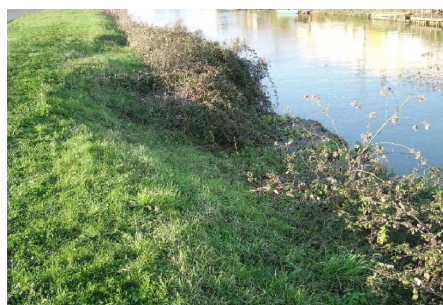
FIG.1 – Glissement rotationnel observé sur le site d'étude
