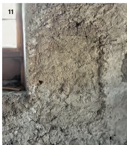
Fig. 11 Ouverture sud bouchée (photo AAM, Moudon).
