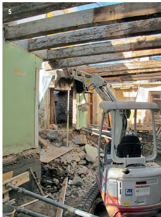
Fig. 4 Vue de la cheminée après la démolition des murs de l'étage et de la toiture. On distingue sur le conduit les traces des toitures successives (© Archéologie cantonale, Lausanne, photo M. Liboutet).
