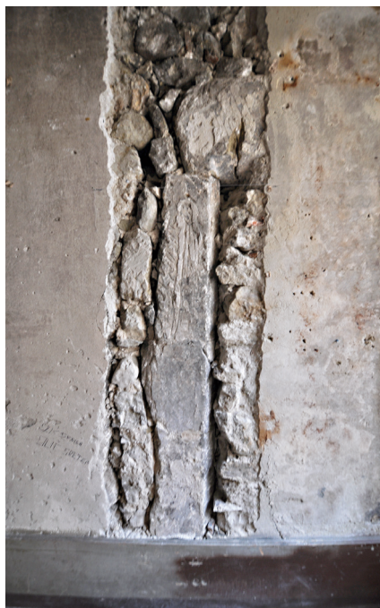
Fig. 3 Piédroit et départ de linteau dégagés dans le mur mitoyen avec le n° 37, au premier étage
