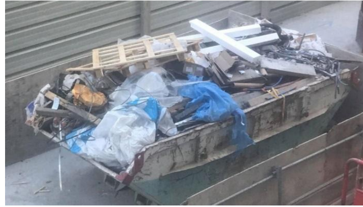
Figure 1 : Exemple de faibles pratiques de tri sur un site de construction (Copyright : Bauby, 2020)
