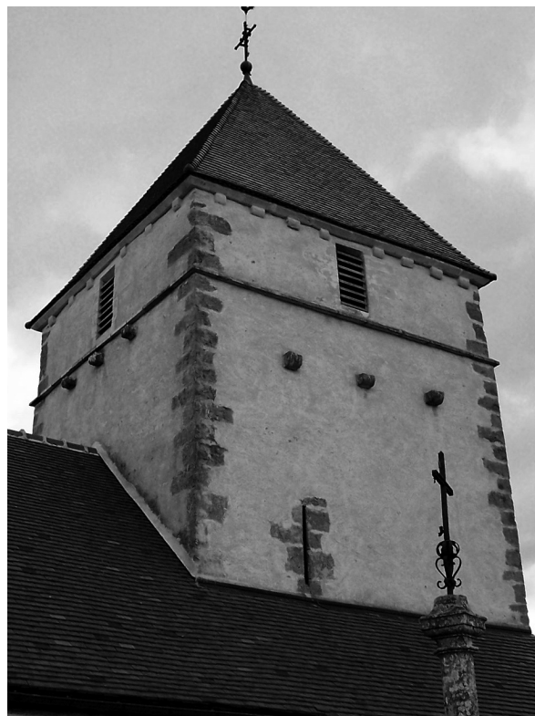
Fig. 30 : vue des vestiges de couronnement sur l'église Saint-Barthélemy de Montigny (21).
