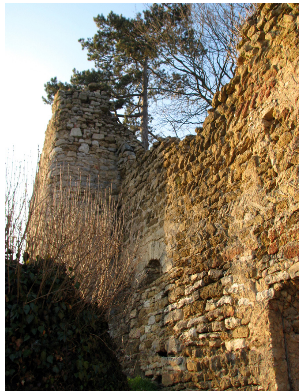
Fig. 12 : face sud du bâtiment 2 avec son appareillage en opus mixte (photo F.B.)
