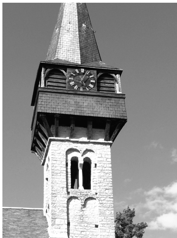
Fig. 31 : vue des vestiges du hourd sur le clocher de l'église de Laizé (71).
