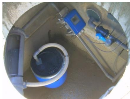
Figure 3 : Photo du dispositif expérimental dans un puits de mesure.
