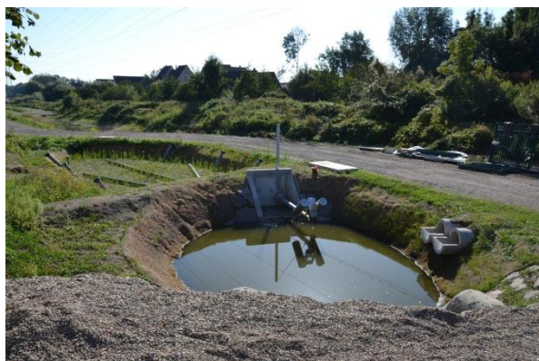
Figure 6. Ensemble de la filière de traitement des effluents provenant du bassin versant n°1 (le 7/09/12)
