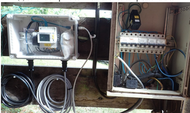
(b) Image d'un capteur : Coffret étanche contenant le compteur (gauche) et armoire dans laquelle des points de mesures sont effectués (droite).
