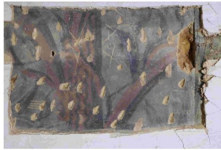
Motif de rinceau, décor bûché lors des réfections modernes, mur Sud du 1 er étage
