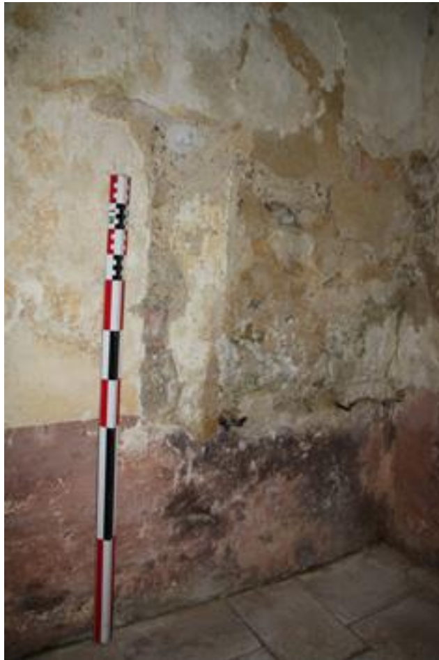
Fig. 89 - Possibles traces du petit appareil présent dans la partie inférieure du parement intérieur du mur nord de la tour-clocher
