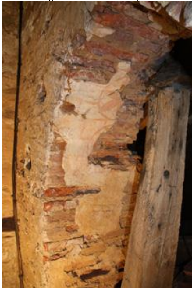
Fig. 36 - Enduit peint présent dans l'intrados de la porte
