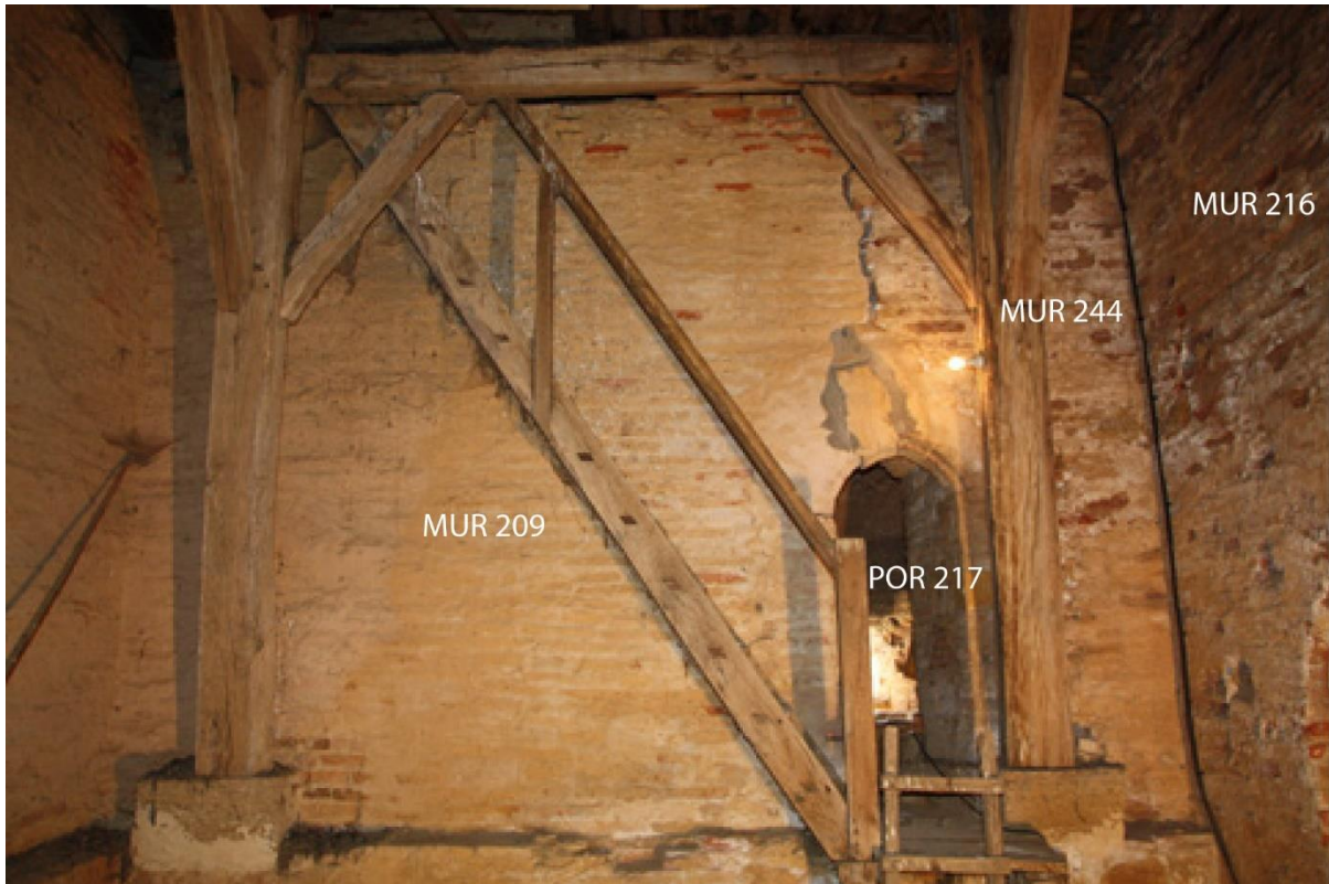
Fig. 61 - Mur sud de la surélévation de la tour-clocher en maçonnerie de briques
