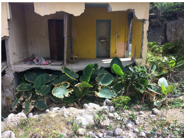
Habitation détruite par une crue diluvienne lors du passage de l'ouragan Maria à Berekua, Dominique (Battut, 2019)
