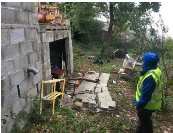
Le Teil, rue Joseph Lapierre : de mur parapet ayant basculé (phénomène hors plan)
