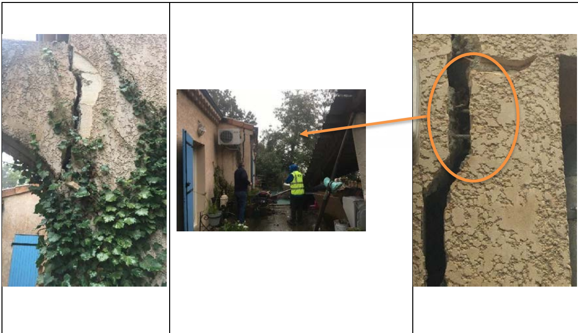
Figure 6-9 : Le Teil, rue Joseph Lapierre –Maison récente (10 – 15ans). Une poutre de décoration en béton préfabriqué au niveau de la terrasse s’est désolidarisée. Au niveau de l’appui de la poutre, et sur le pignon opposé, le chaînage horizontal est rompu par défaut de recouvrement des barres et défaut d’ancrage.
