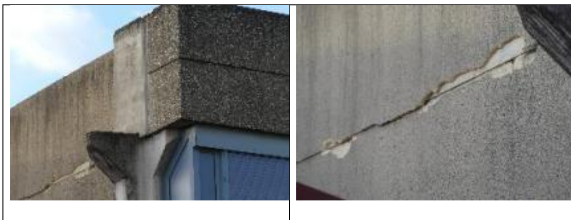
Figure 6-26 : Vue d'une poutre préfabriquée et du déplacement différentiel entre celle-ci et l'infrastructure.
