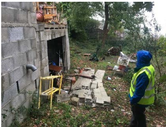
Le Teil, rue Joseph Lapierre : de mur parapet ayant basculé (phénomène hors plan)
