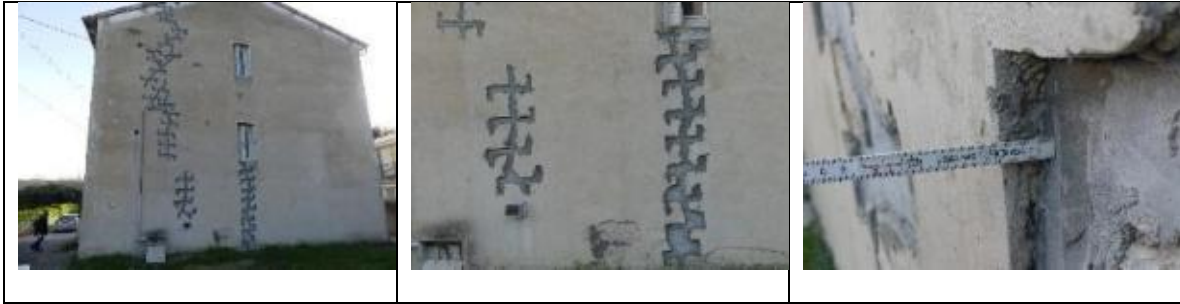
Figure 7-14 : Le Teil : Exemple de travaux par agrafage des fissures après le séisme.
