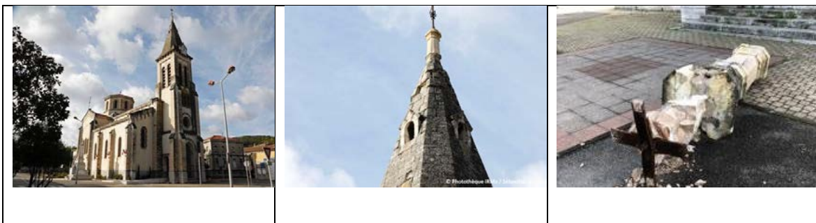
Figure 6-48 : Église Notre-Dame de l'Assomption après le séisme et avant les travaux de sécurisation (vue « Google street view ») –support de la croix déposé sur le parvis de l'église.
