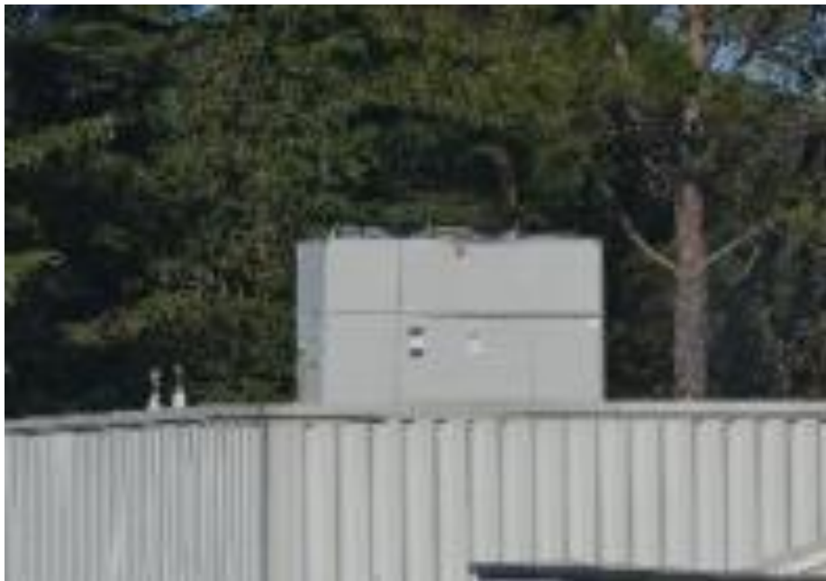
Figure 6-34 : Pompe à chaleur sur la toiture d'un bâtiment métallique de mécanique.
