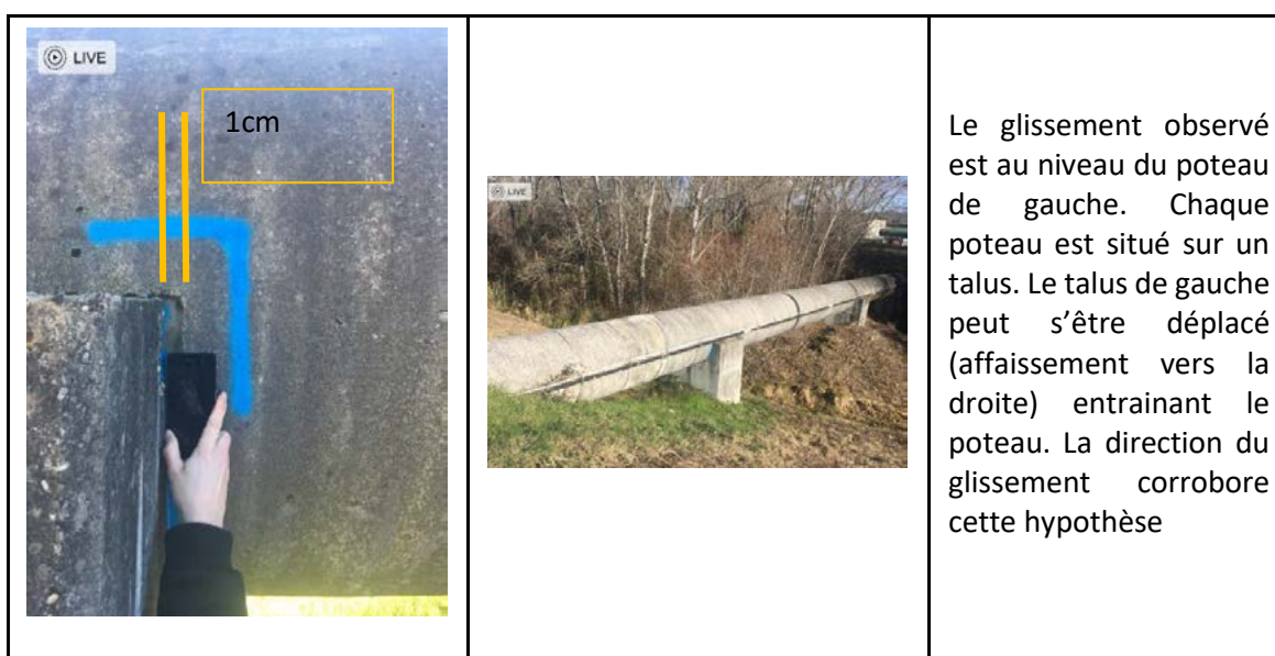
Figure 6-41 : Faibles déplacements relatifs observés au niveau des appuis d'une conduite e prise d'eau.
