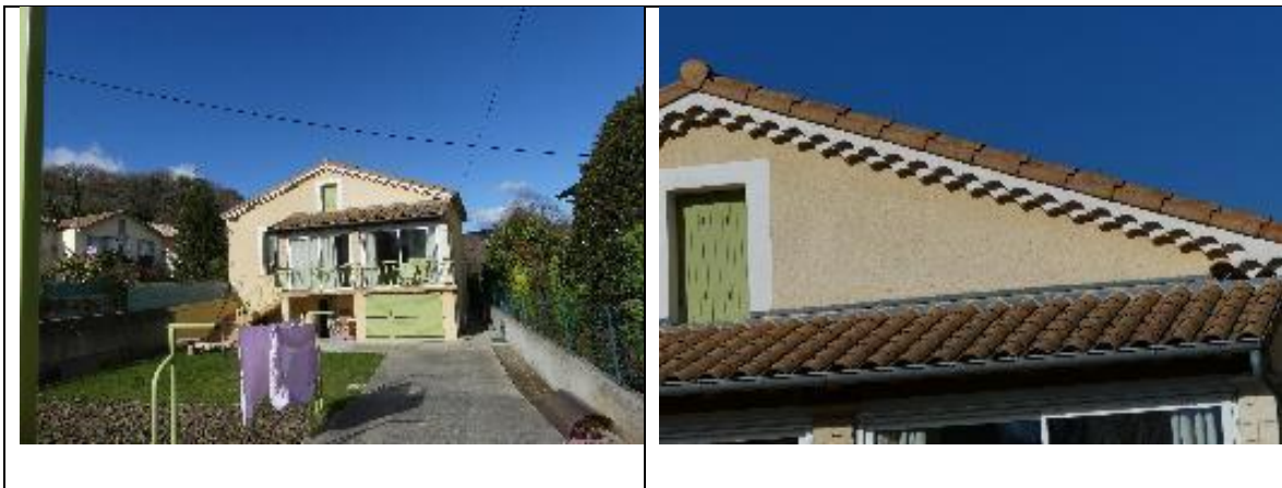
Figure 7-15 : Villa n°2 ayant fait l'objet de travaux a subi peu de quelques dommages.
