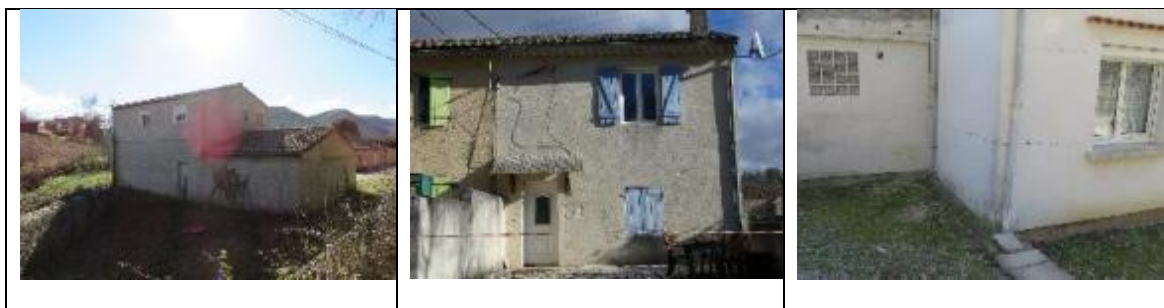
Figure 6-7 : Viviers - Exemple de maison individuelle en maçonnerie R+1 sans dégât apparent -b) Maison en pierre très endommagée située à 400m c) Maison en maçonnerie endommagée suite tassement de sol dû au séisme.
