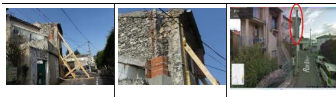
Figure 6-31 : Cheminée endommagée -quartier Frayol bas; à droite photo « Google Street view » avant séisme.
