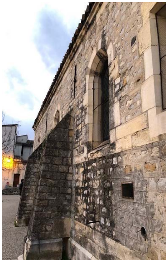
Figure 6-46 : Tirants et contreforts sur l'église Saint-Etienne de Mélas.
