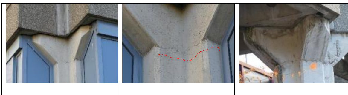
Figure 6-27 : Vue de poteaux préfabriqués, endommagés en tête.
