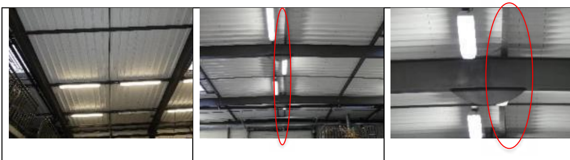
Figure 6-21 : Du centre à droite : flambement de lierne ; déversement et désalignement de la panne faitière. Photo de gauche prise de loin.
