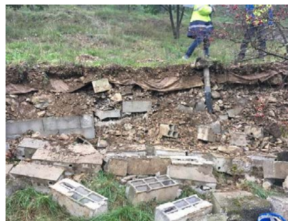
Le Teil, rue Joseph Lapierre : ruine hors plan d'un mur de soutènement de 1m de haut en maçonnerie
