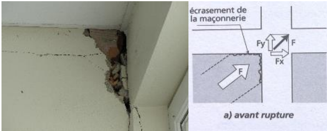
Figure 6-17 : Écrasement du panneau de remplissage sur le poteau en béton armé (P1090013) (Zacek, 1996).
