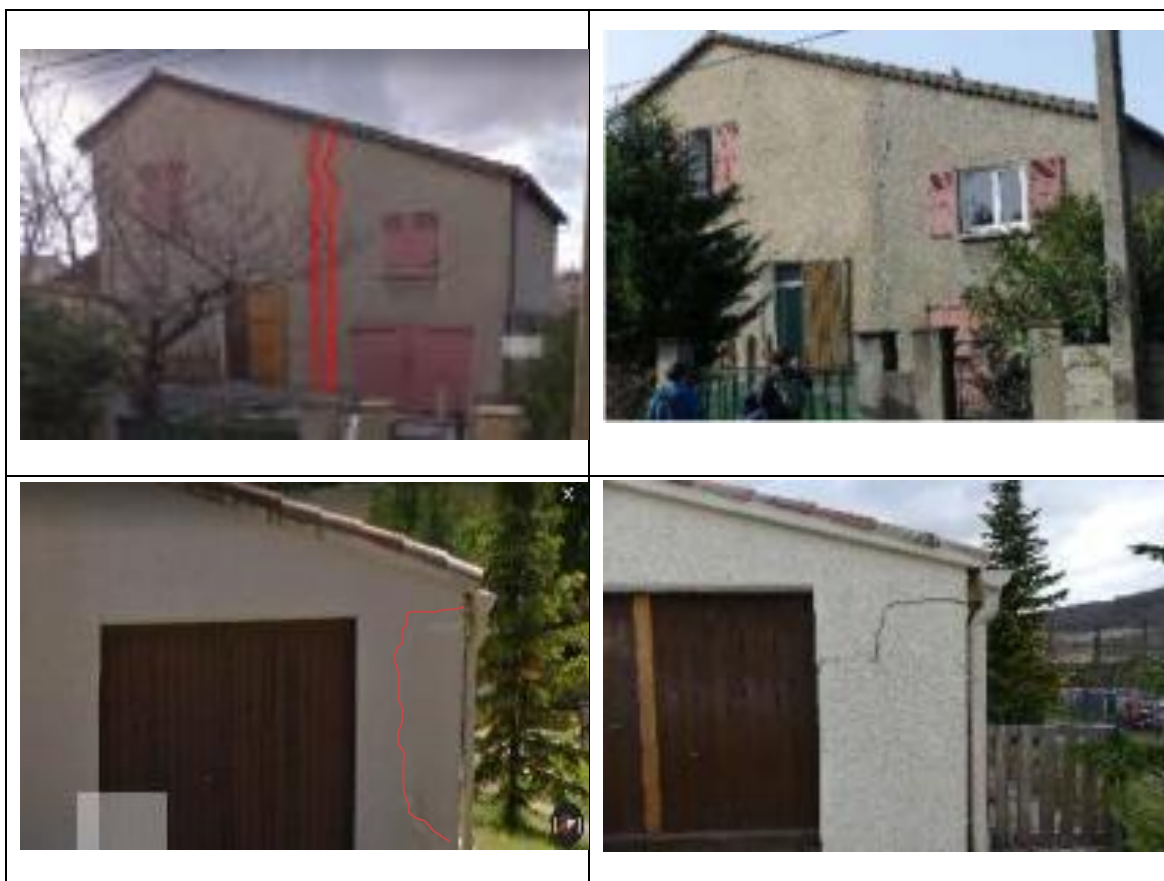
Figure 6-3 : Exemple de dégâts préexistants - gauche : Google street view (12/10) ; droite : photo mission.
