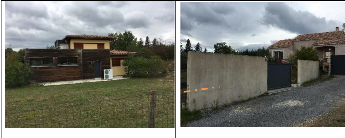
Figure 6-8 : Le Teil, rue Joseph Lapierre –Maison à ossature bois sans dommages de structures. Les cloisons et doublages en plaques de plâtre ont systématiquement fissuré au niveau des jonctions plafond/cloisons, le mur du portail est fissuré horizontalement à la base et une construction située en face du portail, en pierre (chapelle), s’est effondrée.
