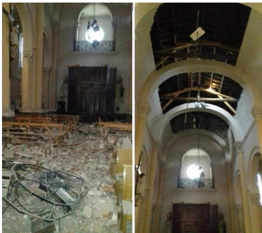
Figure 6-49 : Effondrement de la voûte à l'intérieur de l'église Notre-Dame de l'Assomption (photo https://www.azurseisme.com/Seisme-de-Montelimar.html ).
