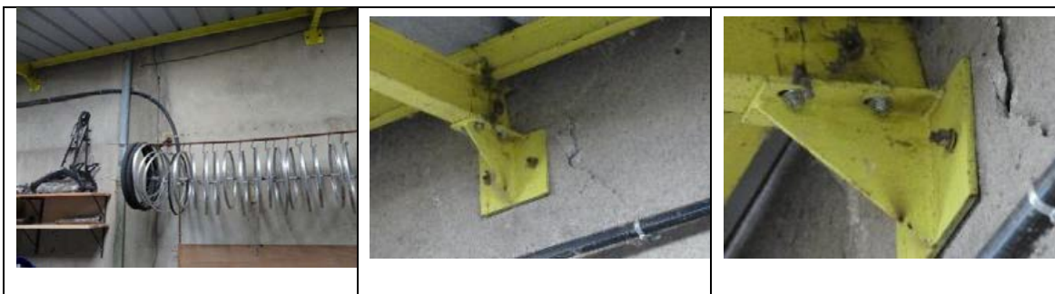
Figure 6-23 : Endommagement au droit de l'ancrage de la poutre métallique de toiture dans le mur en maçonnerie.
