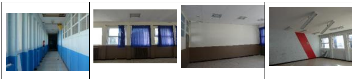
Figure 6-14 : De gauche à droite : vue façade nord couloir du 1 er étage Blocs 1 et 2 ; vue façade sud salle au 1 er étage ; vue mur refend salle au 1 er étage ; vue salle au rez-de-chaussée.
