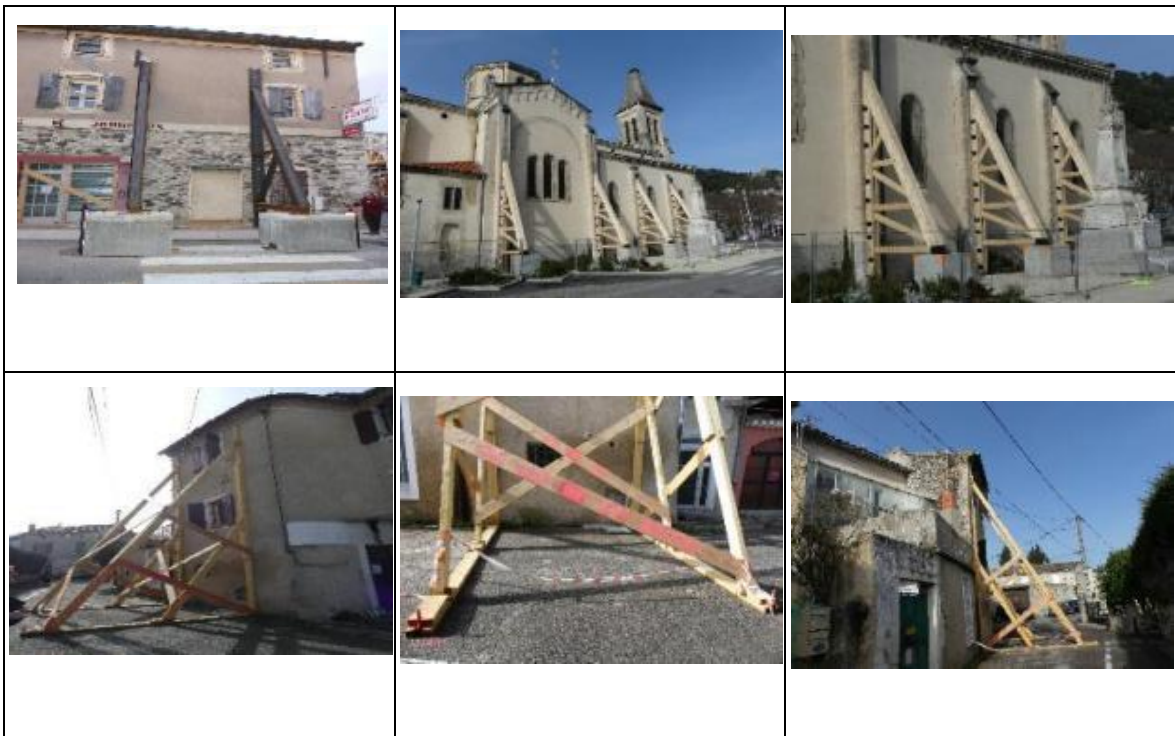
Figure 5-3 : Confortement de façade avec mise en place de contrefort : Route N102, Eglise, Bâtiment quartier Frayol.
