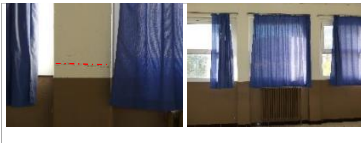
Figure 6-16 : Façade : Cisaillement des poteaux en béton armé bridés par les allèges maçonnées Zoom et vue large .
