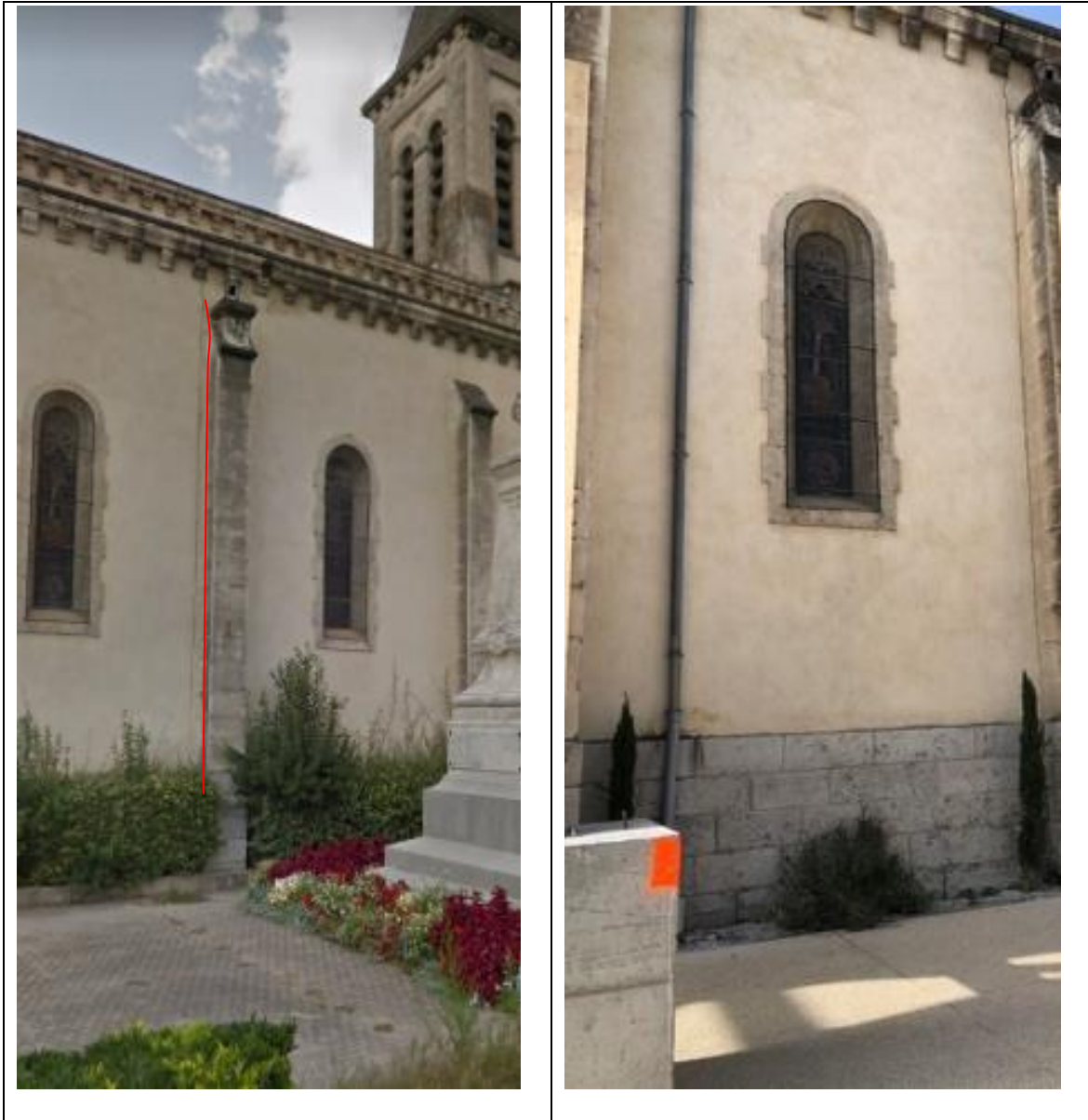
Figure 6-47 : Dégâts initiaux sur les murs extérieurs de l'église Notre-Dame de l'Assomption au Teil.
