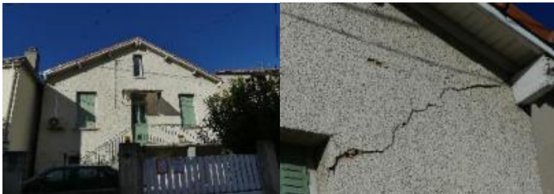
Villa n°6 : Fissure oblique à l'angle de la fenêtre jusqu'en rive de mur
