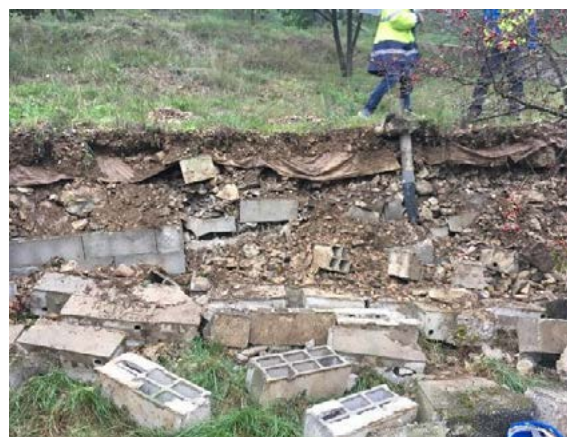
Le Teil, rue Joseph Lapierre : ruine hors plan d'un mur de soutènement de 1m de haut en maçonnerie
