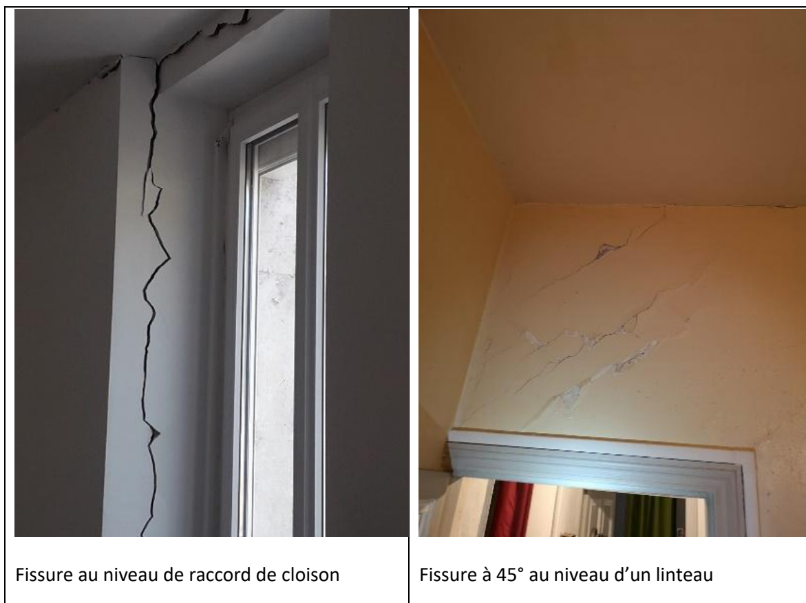
Figure 6-40 : Exemples de fissures dans les cloisons en plâtre.
