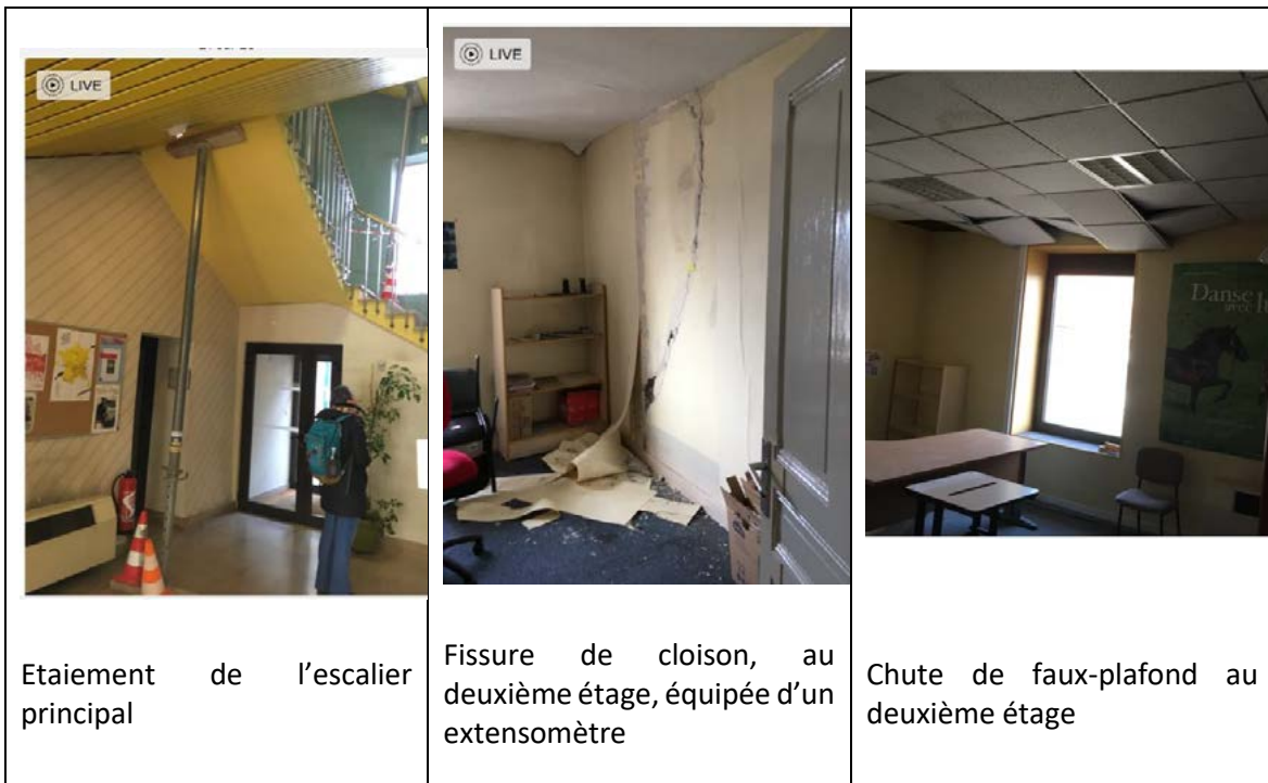
Figure 6-28 : Mairie du Teil – dommages intérieurs.
