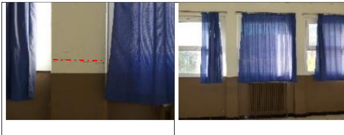
Figure 6-16 : Façade : Cisaillement des poteaux en béton armé bridés par les allèges maçonnées Zoom et vue large .
