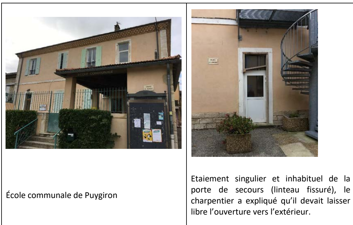
Figure 6-29 : École de Puygiron – faible endommagement.
