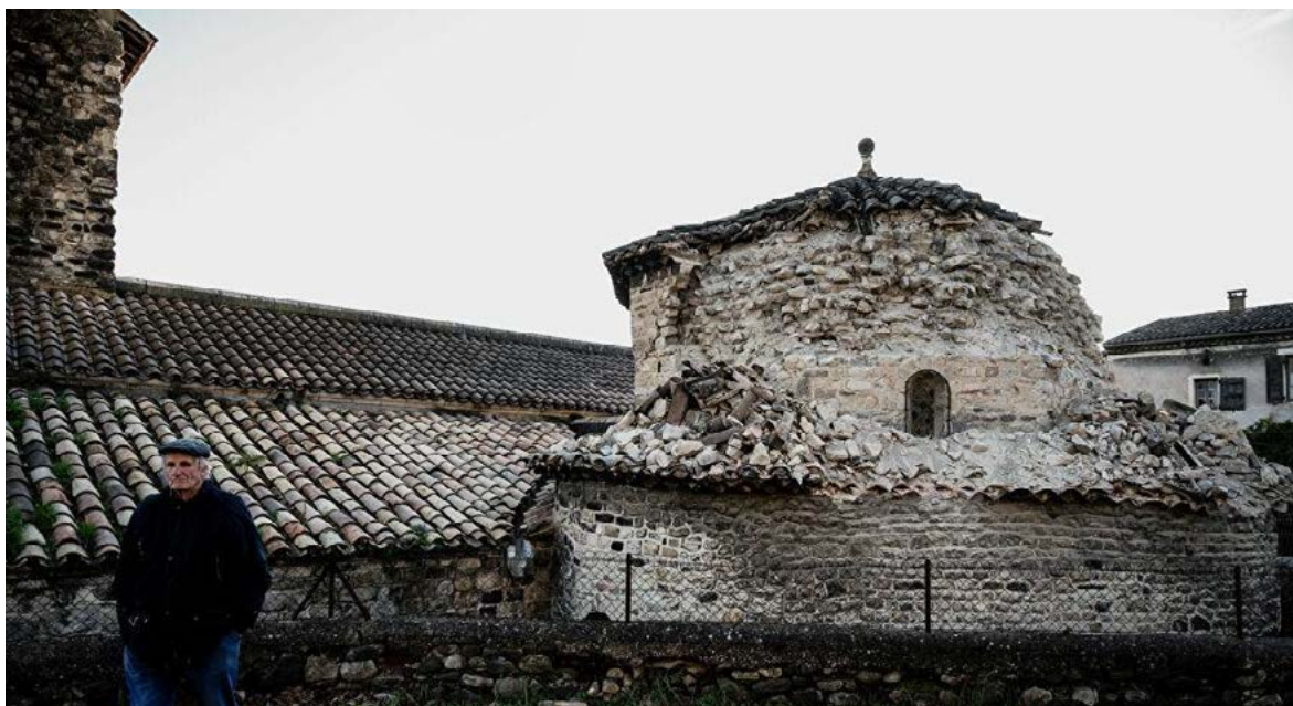
Figure 6-44 : Dommages sur la toiture du baptistère (photo avant séisme extraite de : http://www.patrimoine-ardeche.com/visites/melas.htm , photo sans bache AFP- Jeff Pachoud).
