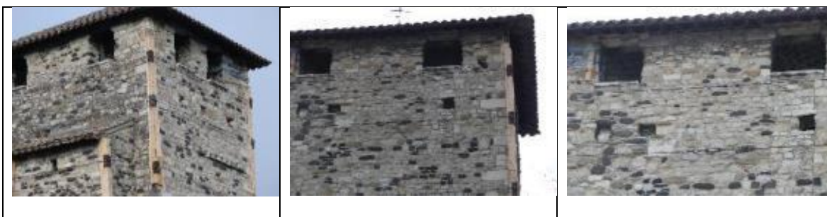
Figure 5-4 : Mise en place d'une ceinture par câble autour du clocher de l'Église Mélas.
