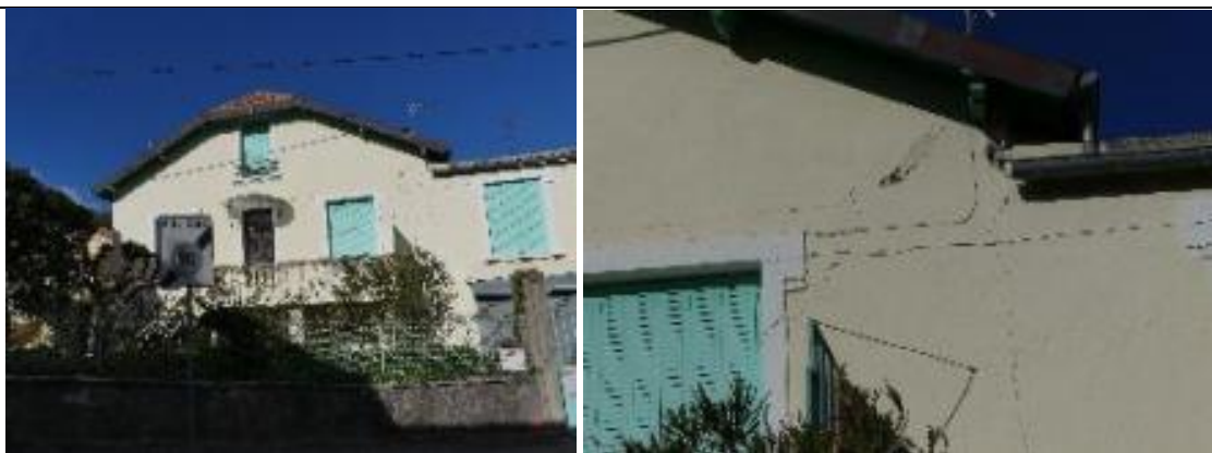
Villa n°4 : Fissure oblique à l'angle de la fenêtre jusqu'en rive de mur et fissure verticale (accentuée mais existante) à la jonction avec le bloc voisin R+1
