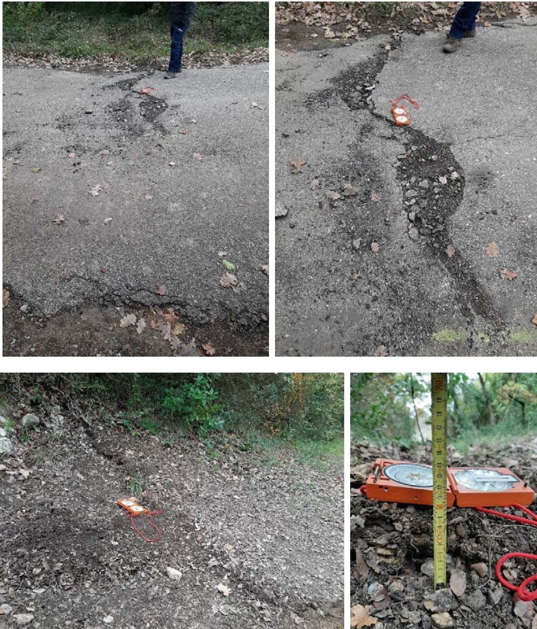
Figure 3-2 : Traces de la rupture sismique en surface. En haut : sur une route située à proximité du hameau de la Rouvière, à l'extrémité nord-ouest de la zone de rupture identifiée sur l'image satellite traitée par interférométrie radar. En bas : sur un chemin situé à l'extrémité sud-est de cette zone de rupture. On y observe un déplacement de plusieurs centimètres de part et d'autre de la zone de rupture, avec une surrection des terrains situés au sud-est relativement à ceux situés au nord-ouest.
