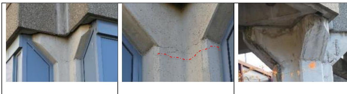
Figure 6-27 : Vue de poteaux préfabriqués, endommagés en tête.
