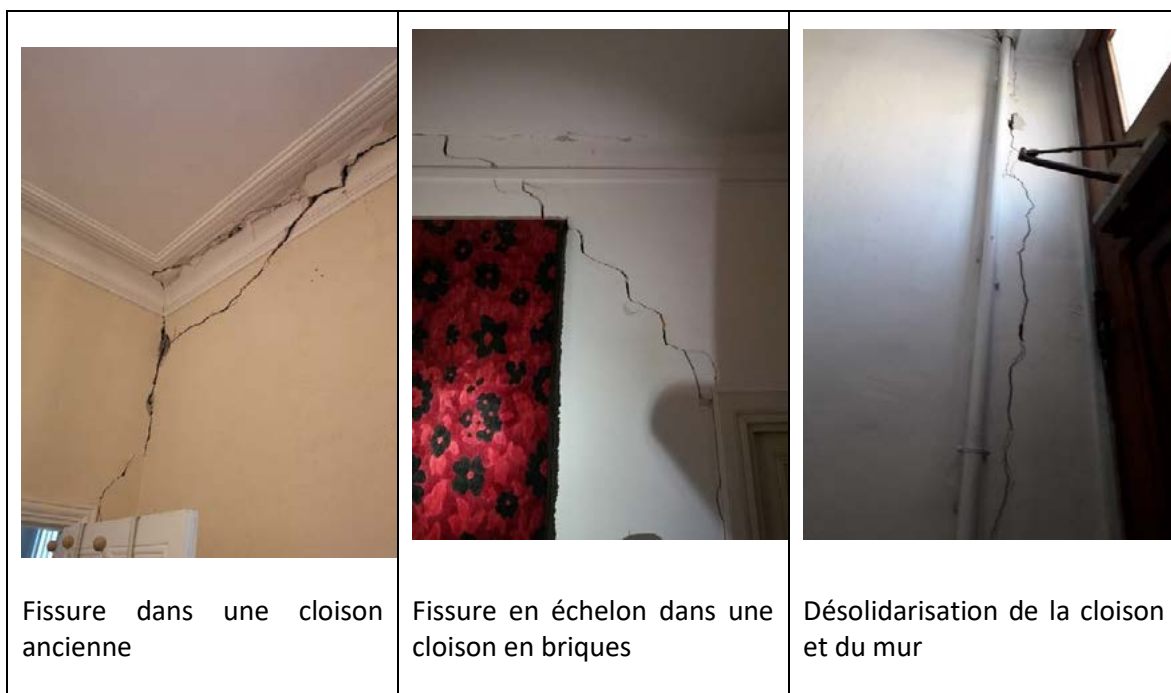
Figure 6-39 : Exemples de fissures dans les cloisons en briques.
