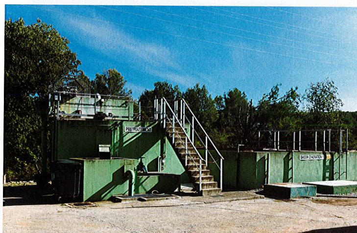
Photo 1 : Station d'épuration de la commune de Saint-Mathieu de Tréviers. Cliché Ph. Crochet. Water treatment plant of Saint-Mathieu de Tréviers Municipality.
