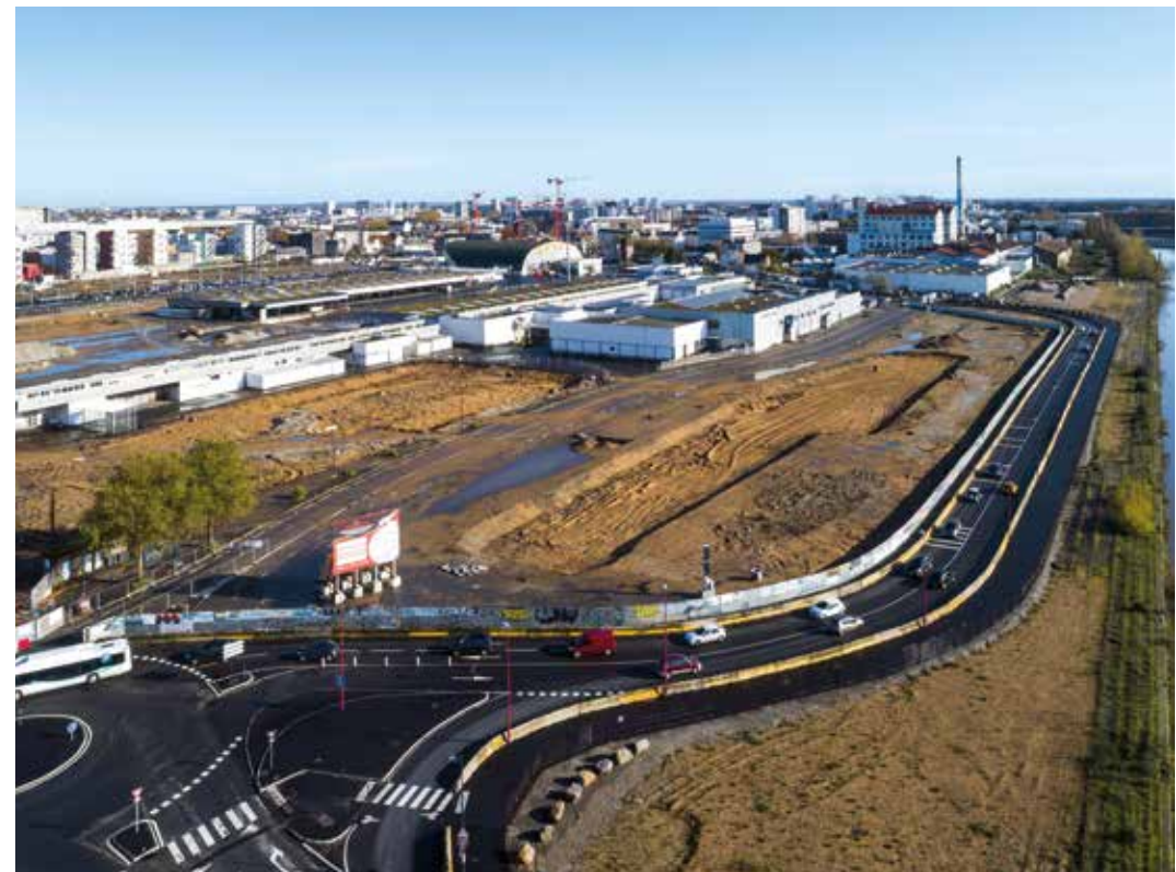
Chantier du Chu, ancien MIN de Nantes, novembre 2019. © Photo Valéry Joncheray / Samoa.
