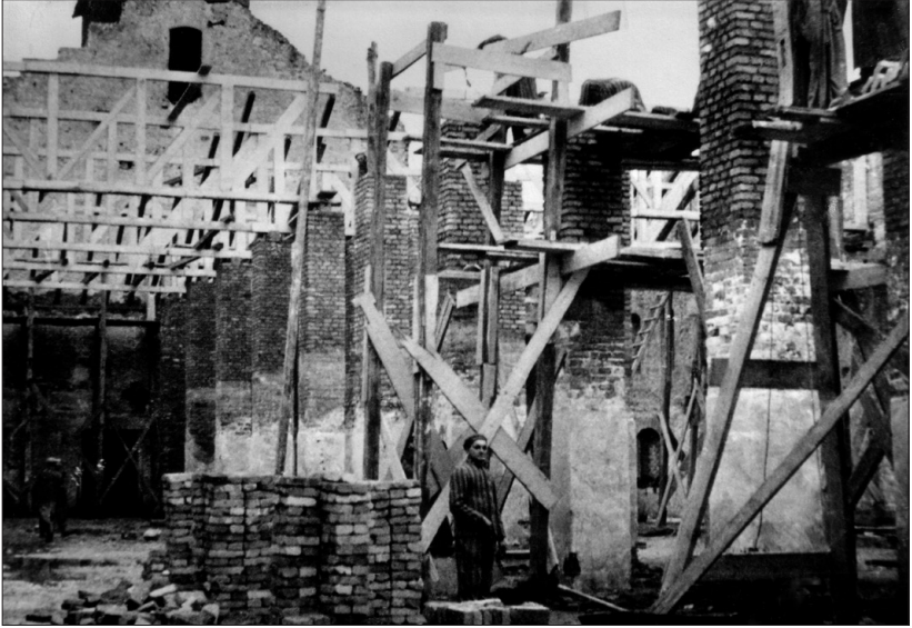
La construction de l'usine Siemens dans les bâtiments d'une ancienne briqueterie, Bobrek, 1944. Photographie d'un ingénieur allemand.
