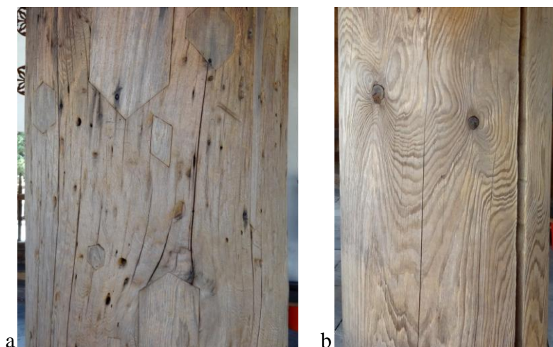
Figure 5 : a : poteau en bois ancien avec des parties restaurées ; b : poteau intégralement remplacé lors d'une restauration.
