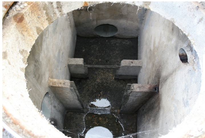
Figure 2 Un ouvrage de régulation saboté
