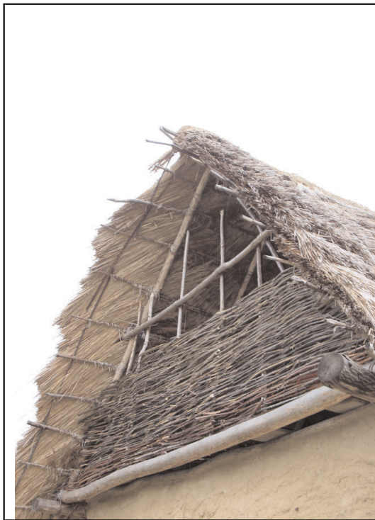
Fig. 167 : clayonnage du pignonsud en cours, dispositif destiné à la ventilation du gr'enier
