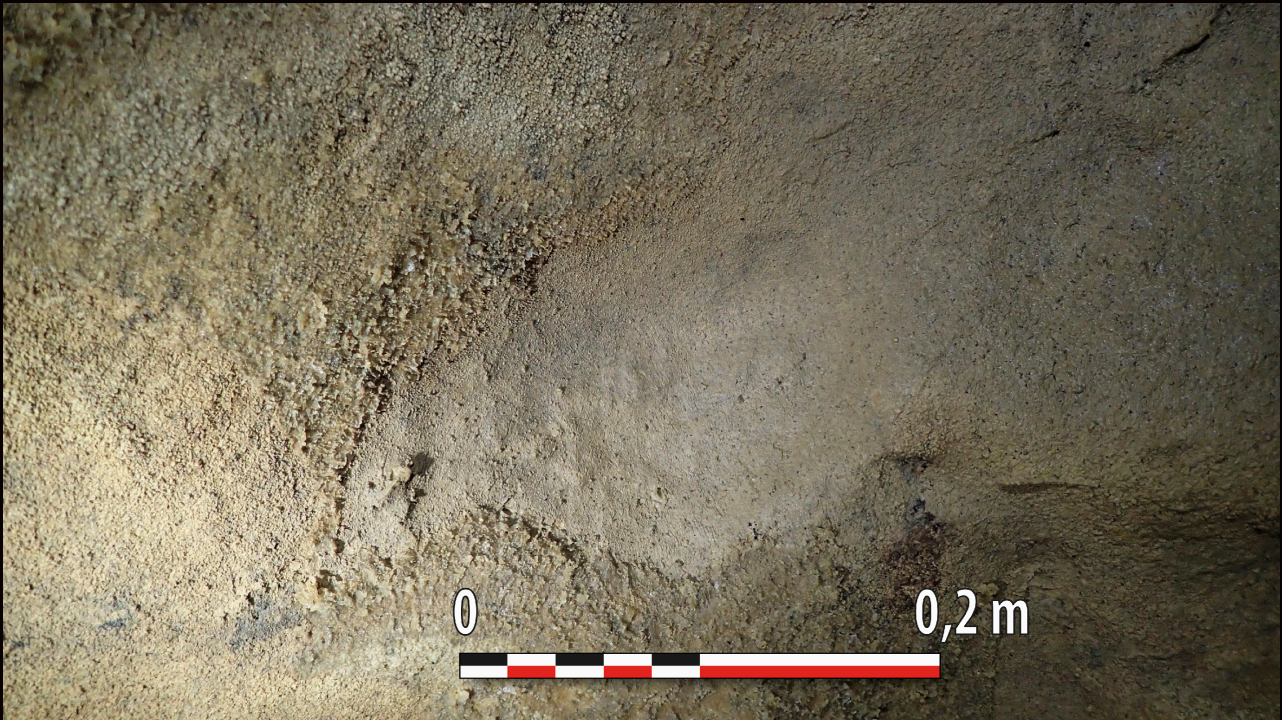
Figure 14 : état des parois dans la galerie des Chauves-Souris. Encrouement de calcite formé à partir des films d'eau issus de la condensation (cliché © Didier Cailhol).
