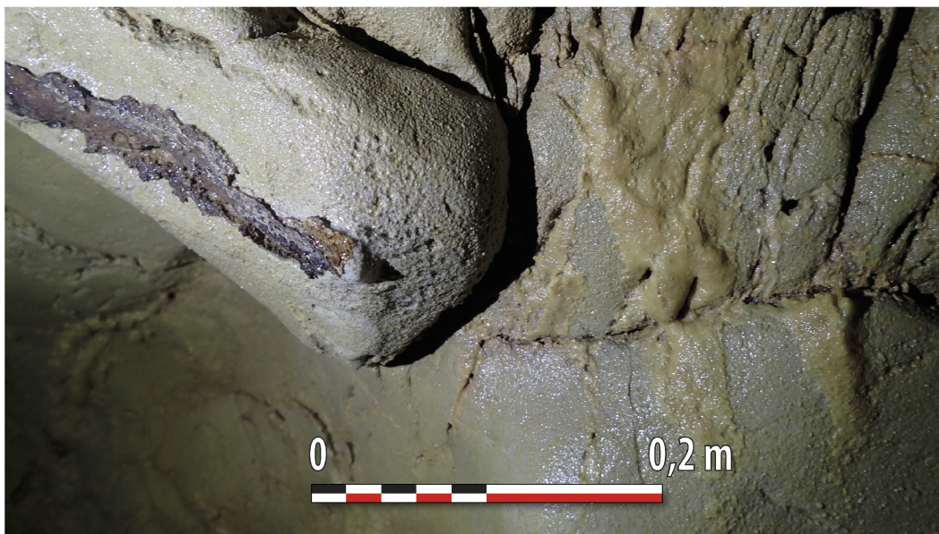
Figure 15 : état des parois dans la galerie des Chauves-Souris. Corrosion de la paroi calcaire et des voiles de calcite sous l'action de la condensation. L'hydroxyapatite insoluble reste en surépaisseur et se détache du calcaire en cours de dissolution (cliché © Didier Cailhol).
