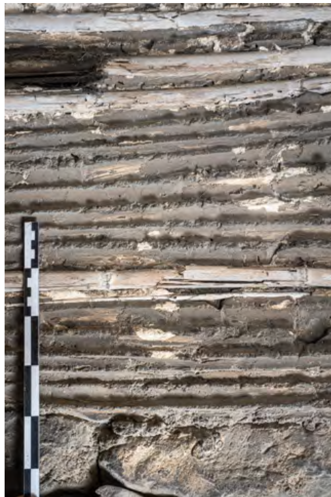
Fig. 172 – ORANGE, PCR « Architecture, technique et décor du théâtre antique ». Détails des négatifs de roseaux et roseaux encore en place sous la voûte (cliché L. Damelet/CCJ, 2020).
