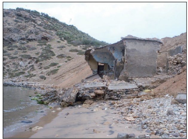
Photo. 5. — Une maison, à l'extrémité est de la baie de Bouzedjar, sapée et détruite par les vagues (cliché GHODBANI, 2008).
