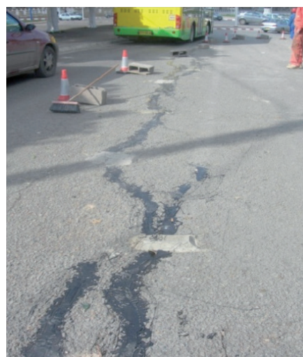
Photo. 6. — Chaussée endommagée par une fissure longitudinale.
