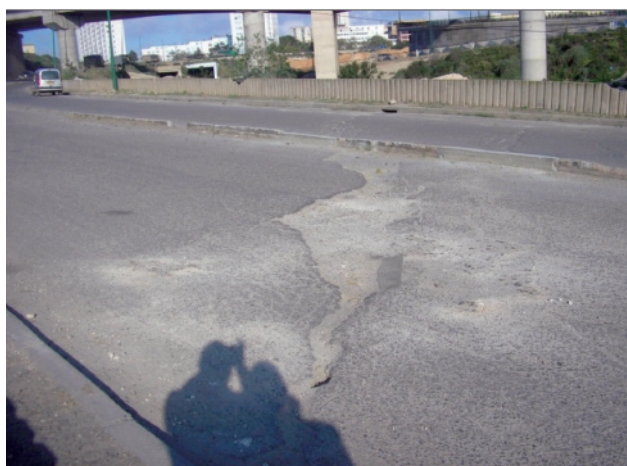
Photo. 5. — Fissure affectant la chaussée menant au port à conteneurs.
