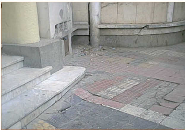
Photo. 9. — Affaissement avec déformation des trottoirs (angle Boulevard Emir Abdelkader).
