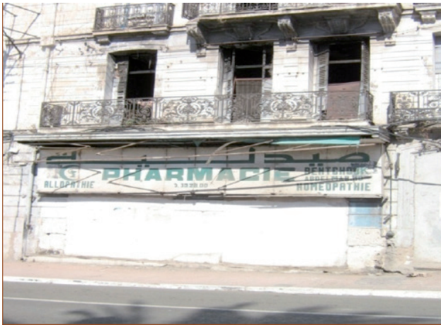
Photo. 8. — Affaissement du plancher de la pharmacie.
