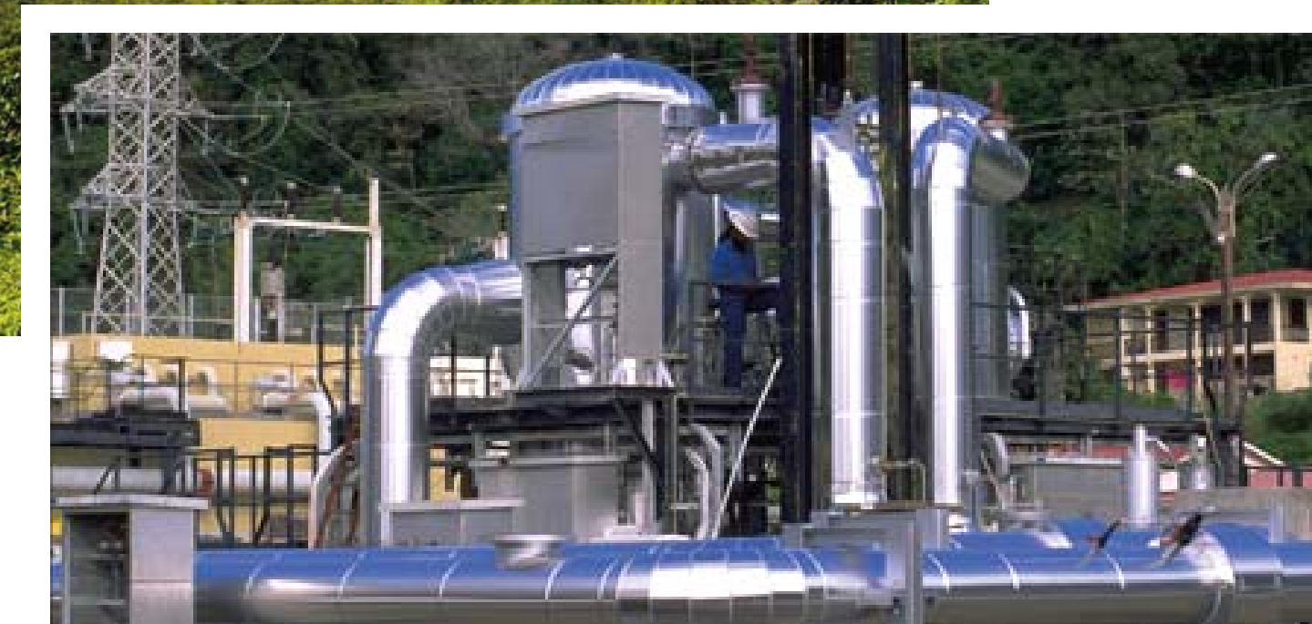
La centrale géothermique de Bouillante
