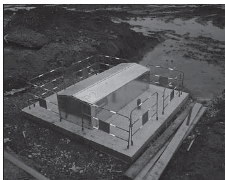
Figure 11. Vue générale de la porte filtrante
