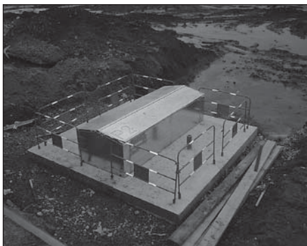
Figure 11. Vue générale de la porte filtrante
