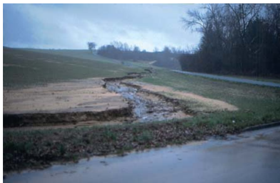
Figure 4 : Forme d'érosion régressive déterminée par la rupture de la protection du sol (modification de profil du terrain et création d'un talus non protégé pour le passage d'une nouvelle route).
