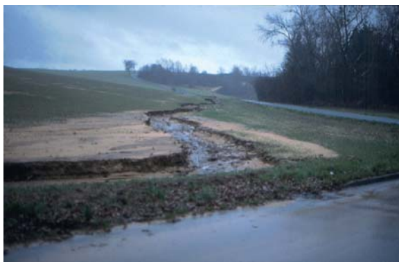
Figure 4 : Forme d'érosion régressive déterminée par la rupture de la protection du sol (modification de profil du terrain et création d'un talus non protégé pour le passage d'une nouvelle route).
