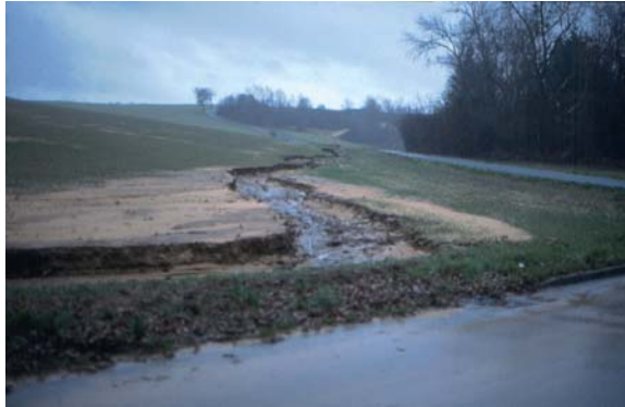
Figure 4 : Forme d'érosion régressive déterminée par la rupture de la protection du sol (modification de profil du terrain et création d'un talus non protégé pour le passage d'une nouvelle route).
