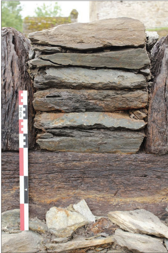
Fig. 8 – Détail d'un hourdis de la façade occidentale du caisson CA19 (cliché : T. Maisonneuve).
