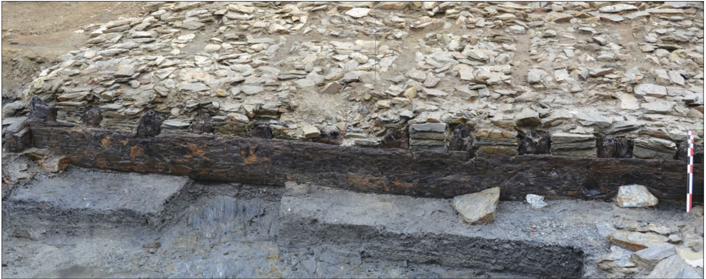
Fig. 21 – Vue du caisson n° 9 habillé de ses planches de bardage en chêne (cliché: J. Mouchard).
