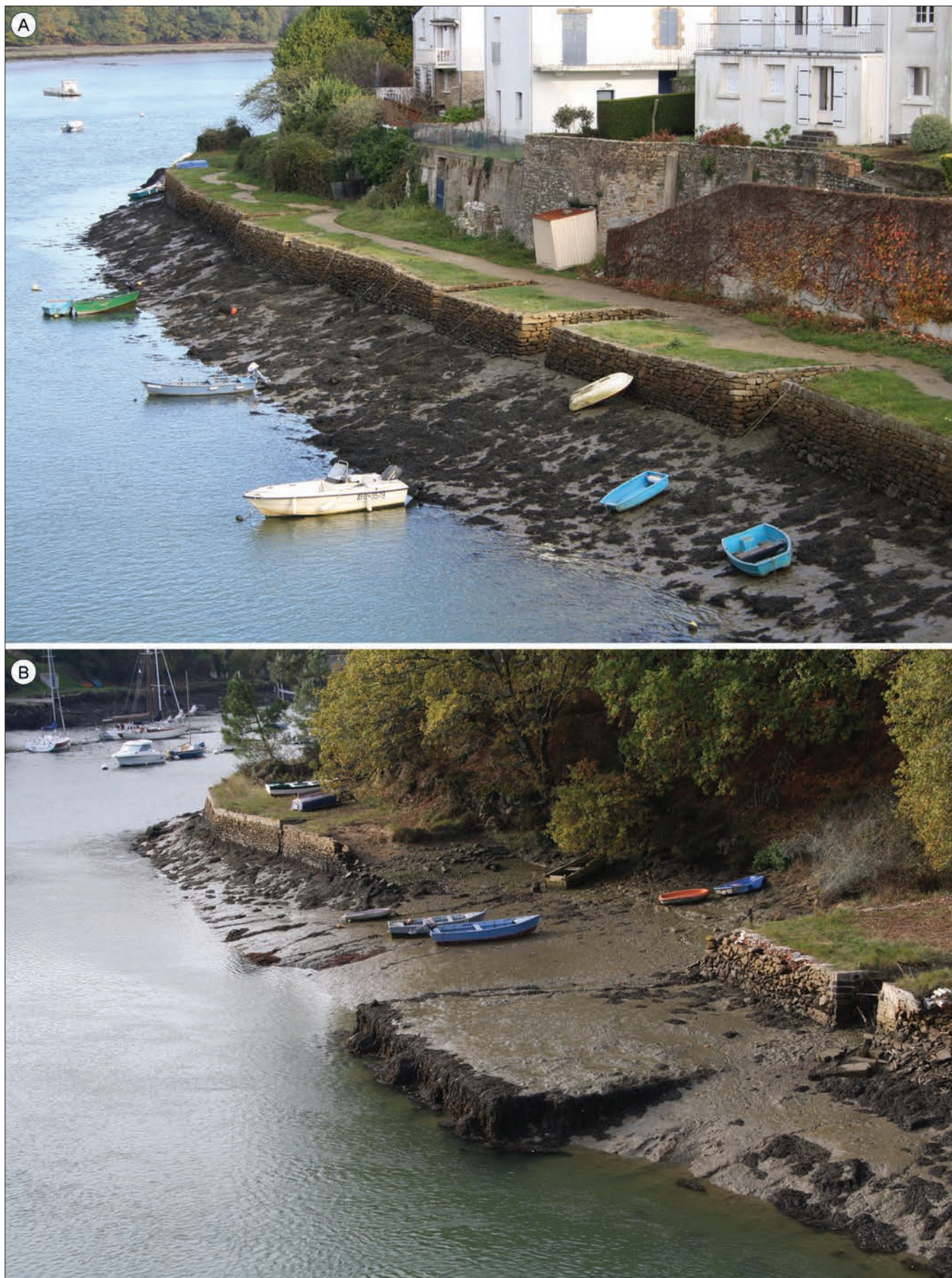
Fig. 24 – Aménagements de berge actuels, en pierre sèche bordant la rivière du Bono, Le Bono (Morbihan) : A, rive gauche ; B, rive droite (clichés : J. Mouchard, 2011).
