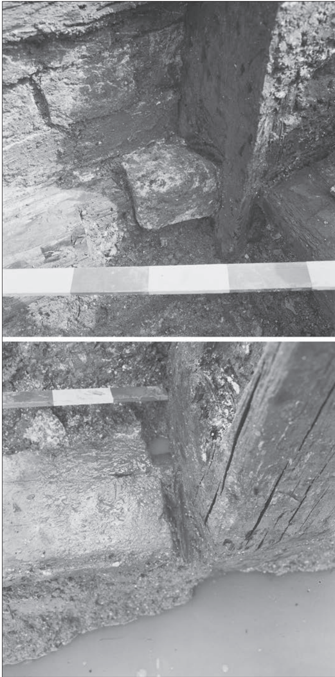
Fig. 12 – Deux exemples de cales entre les pieux verticaux et la première poutre horizontale (inférieure) à l'aide soit d'un moellon, soit d'une petite pièce de bois (coin) (clichés : A. Ferdière).
