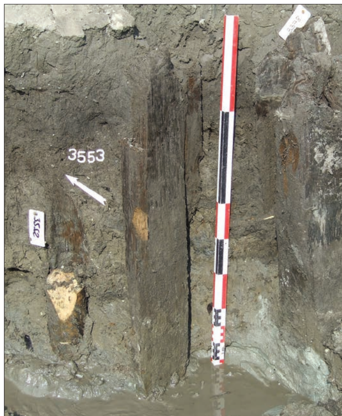
Fig. 12C (ci-contre) – Vue de détail des pieux découverts pendant le démontage de l'état 4 et illustrant un état antérieur (cliché : V. Duphil).
