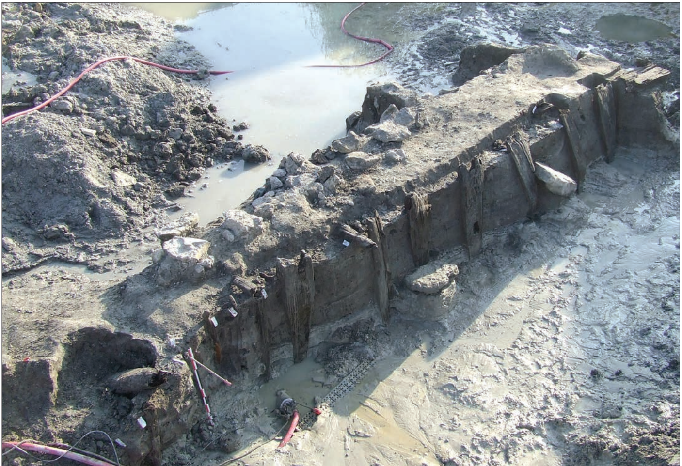
Fig. 10A – Vue d'ensemble de la ligne de palplanches pendant le démontage, état 3 (cliché : V. Duphil).
