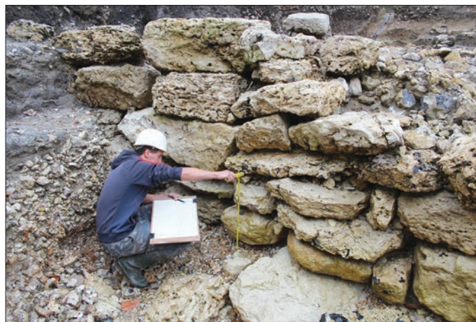
Fig. 15 – Vue rapprochée, depuis le nord, du mur de façade du quai septentrional (états 2 et 3) en cours de relevé (cliché : J. Mouchard).
