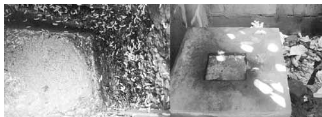
Figure 12 : Fosses trop pleines
