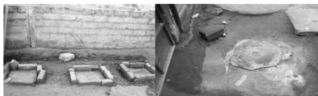
Figure 7B : fosses septiques
