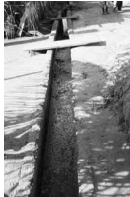
Figure 2 : Eaux usées en stagnation dans les caniveaux
