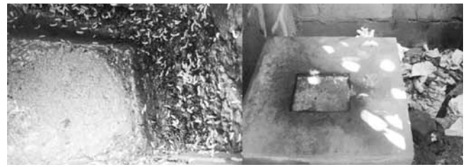
Figure 12 : Fosses trop pleines
