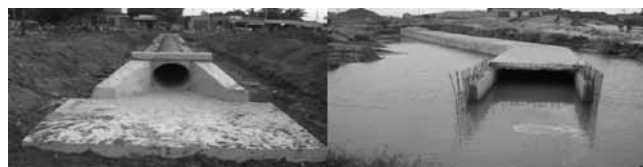
Figure 6 : Systèmes de canalisation conventionnelle
