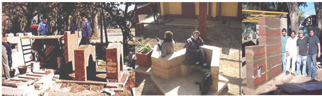
Figura 3. Construcción de equipamiento utilitario en terrenos de la FAU. Izquierdo: equipamiento de juegos infantiles en guardería de la FAU Central: asiento en CRIATiC Derecha: construcción de un monolítico portal en acceso al CRIATiC.
