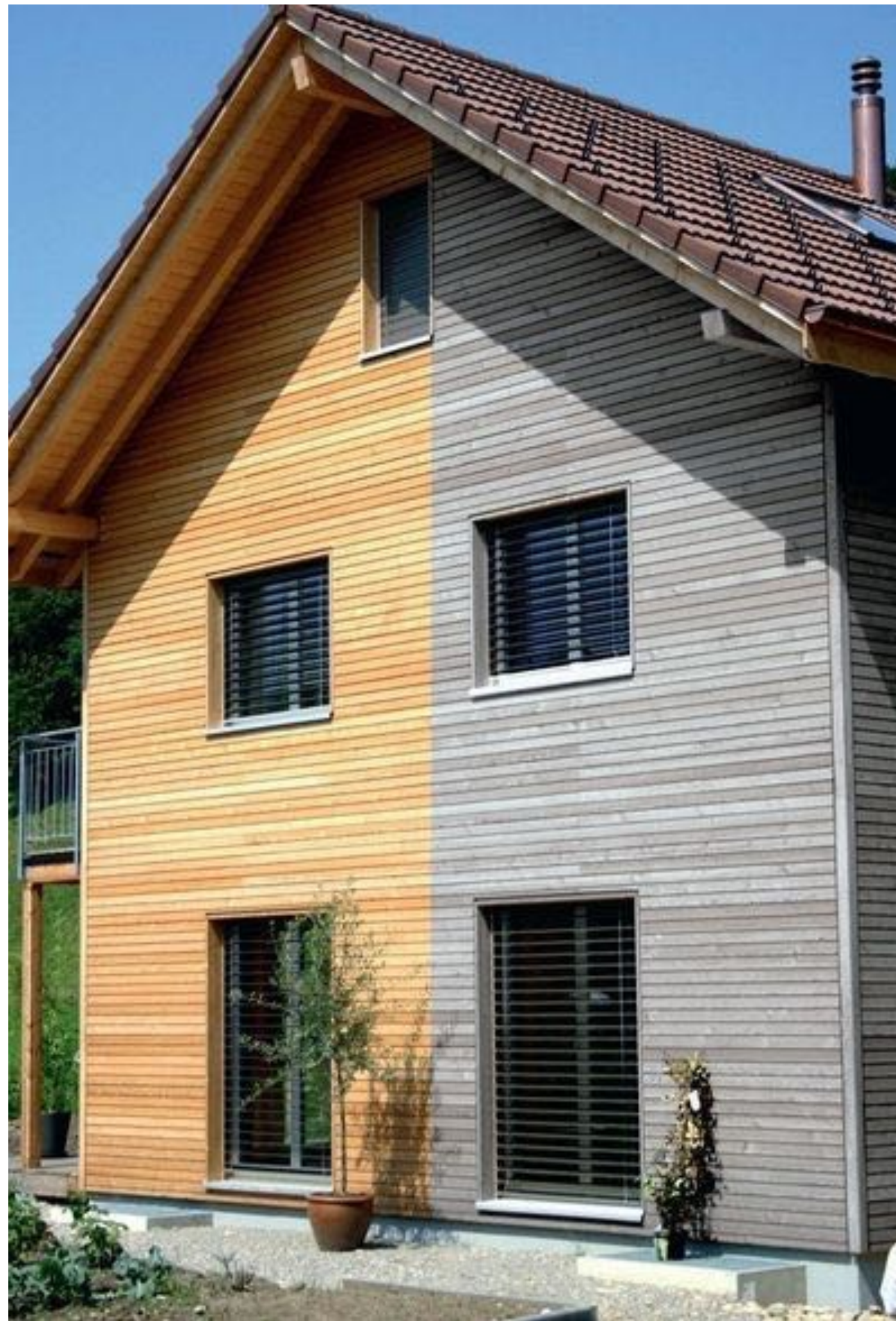
Bardage en mélèze 3 an après application d'un protecteur (gauche) et non traité (droite)
