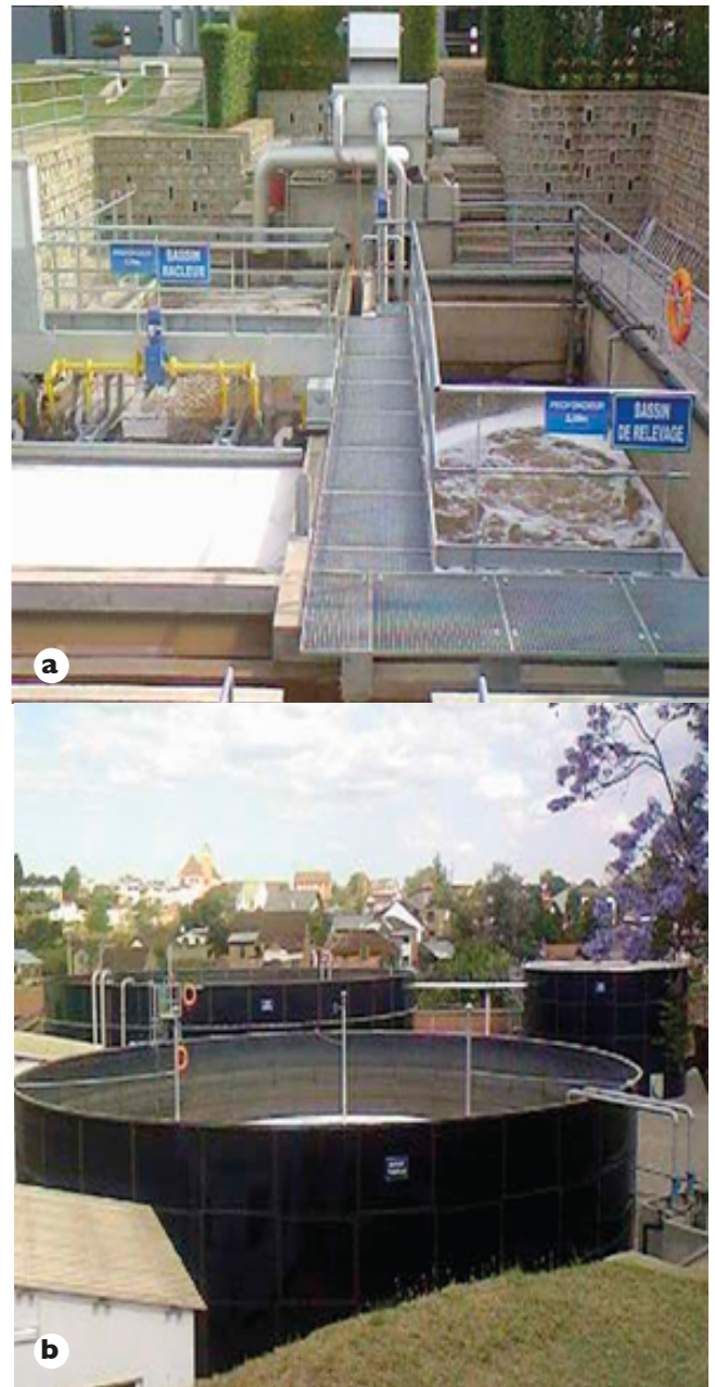
Figure 1. Zones de prétraitement (a) et de traitement principal (b) de la station suivie
