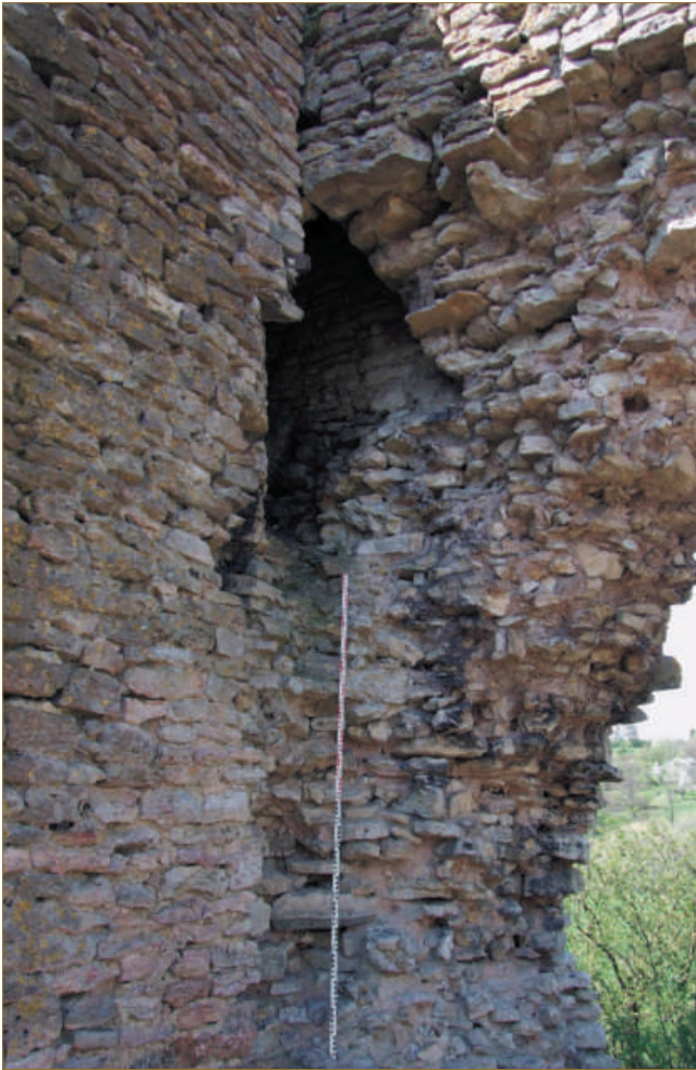
Figure 12 : Cheminée obstruée par un refend sur l'élévation intérieure nord (cliché C. Moulis).
