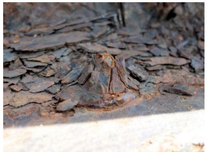
Corrosion avancée des profilés et rivets métalliques - photo LM
