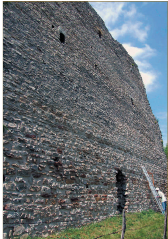
Figure 26 : Bombements observés dans le parement de l'élévation extérieure est, dont le rythme est calé sur celui des assises de réglage (cliché C. Moulis).
