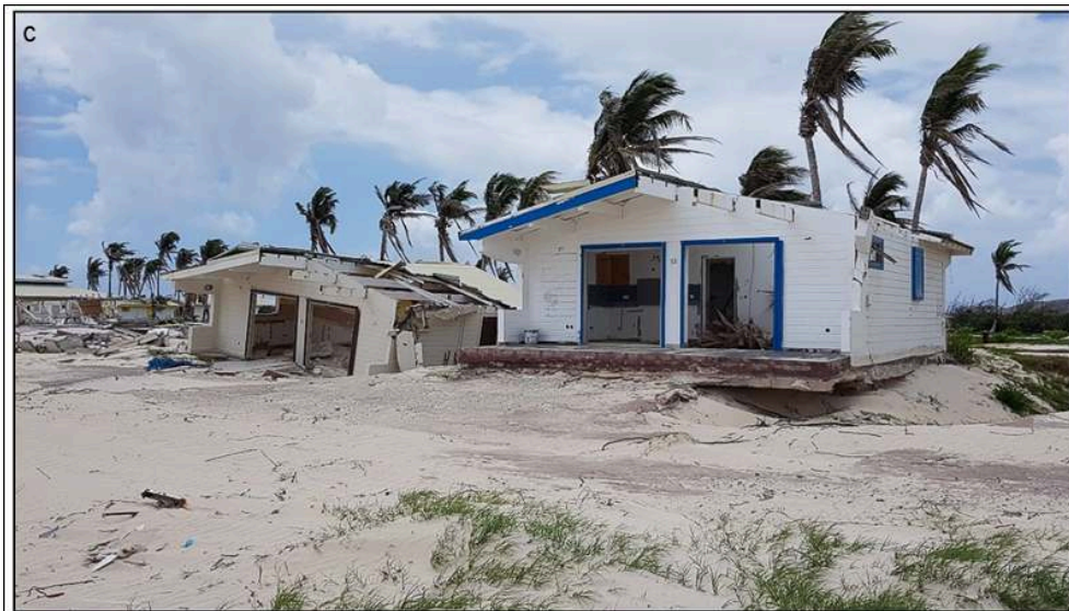
Illustration 5c - Impacts de l'ouragan Irma sur les bâtiments et les infrastructures côtières : inondations des habitations et endommagement des murs, sol, système électrique...
