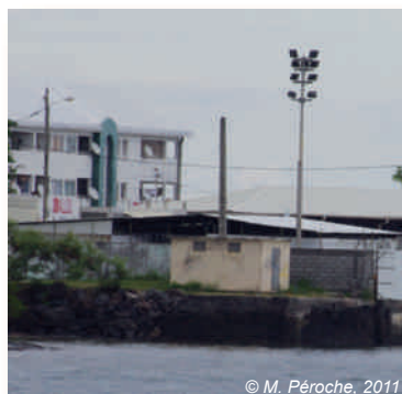
Poste de distribution électrique à Pamandzi, situé à proximité de la mer
