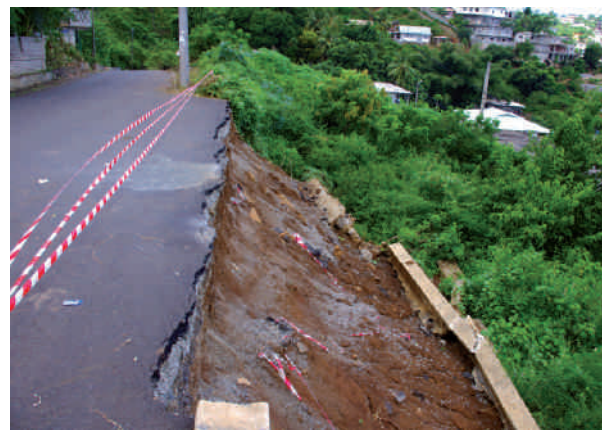
Affaissement d'une route à Sada dû au phénomène de régression de talus
