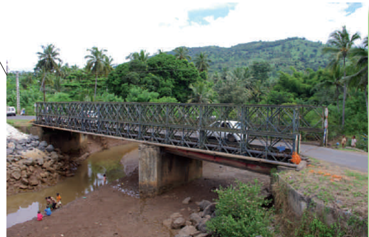
Canalisations à nu sous le pont de Tsoundzou en zone d'aléa sismique fort. Un nouveau pont est en construction
