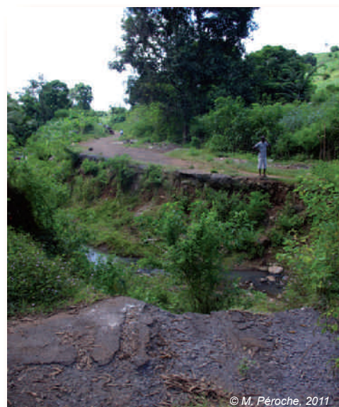
Portion de route emportée par un cours d'eau au niveau de Doujani
