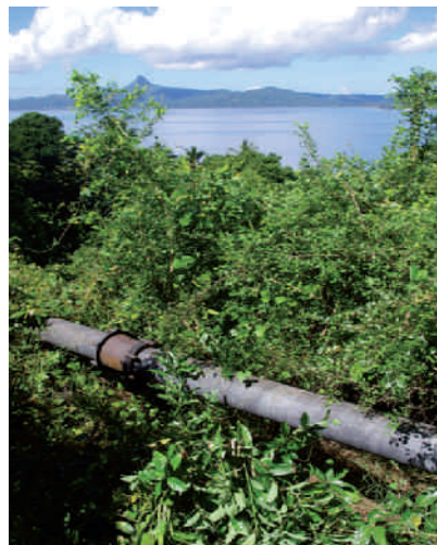
Canalisation très vulnérable à proximité de la route
