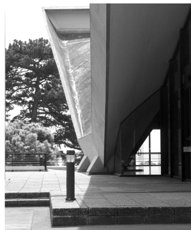
Fig. 3. : Aula de l'École polytechnique fédérale de Lausanne, 1961-1962, Jean Tschumi arch. Détail du voile de béton armé. Wikimedia commons, cliché Port(u)°s, 2008, CC BY 3.0.
