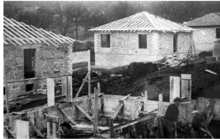
3. Chantier de maisons castors par les ouvriers de la Compagnie des forges de Châtillon-Commentry et Neuves-Maisons, à Chavigny (1953) avec Jacques et Michel André. Archives privées.
